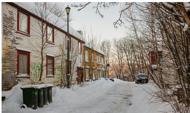
Nedslitt: Noen av husene i Grensen er fraflyttet og ser ut til å være i dårlig forfatning. Foto: TERJE SVAAN
